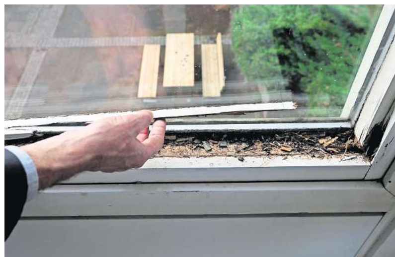
Maroder Holzfensterrahmen im „Neubau“ des Hainberg-Gymnasiums. FOTO: PH
